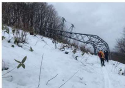
大雪による鉄塔倒壊事例 ※3
