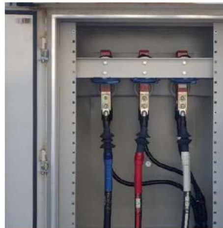
ボルト・ネジ接続 (代替交流電源)
