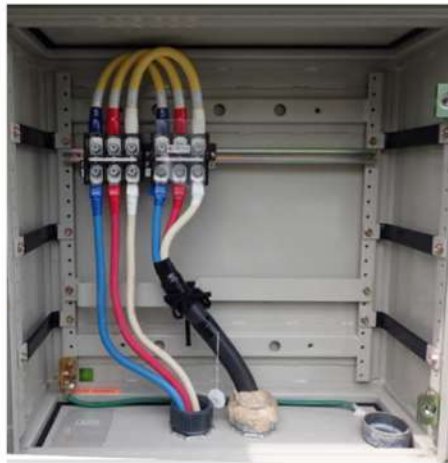
ボルト・ネジ接続 (代替直流電源)
