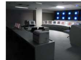
非常用照明点灯時
