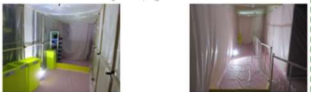
可搬型照明① 可搬型照明② 図3.2-7 可搬型照明（SA）確認状況
