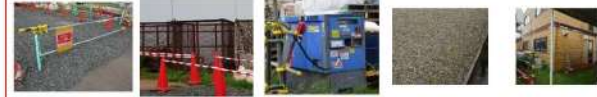
A型バリケード 産廃のゴミ 発電機 砂利 スーパーハウス
