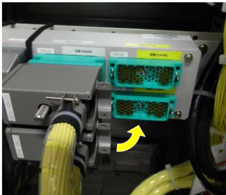
(1次系制御監視盤内 切替器)
