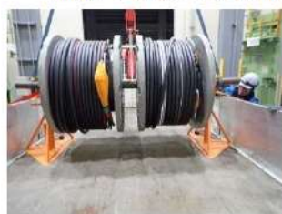
号炉間連絡予備ケーブル
