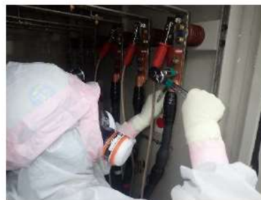
号炉間連絡ケーブル接続（端子） （屋外）
