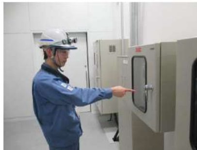
後備蓄電池による受電操作 （中央制御室） （原子炉補助建屋T. P. 17. 8m）
