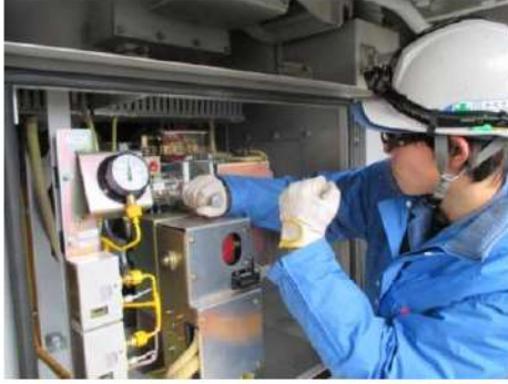
開閉所設備遮断器操作 (屋外)
