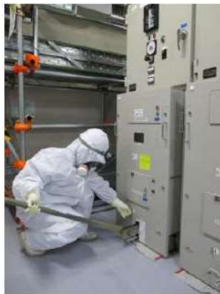
受電遮断器操作 (原子炉補助建屋 T.P. 10. 3m)
