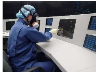
主蒸気逃がし弁開操作 （中央制御室）
