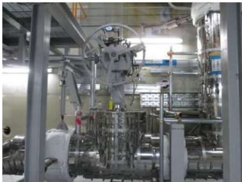
3 A - 余熱除去ポンプ入口弁 (3V-RH-005A)
