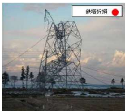
津波による隣接鉄塔の倒壊に伴う送電鉄塔の倒壊事例 ※2
