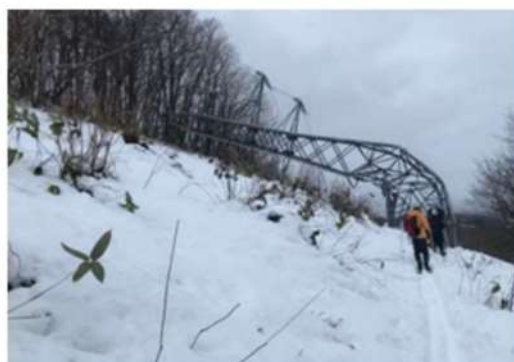
大雪による鉄塔倒壊事例 ※3
