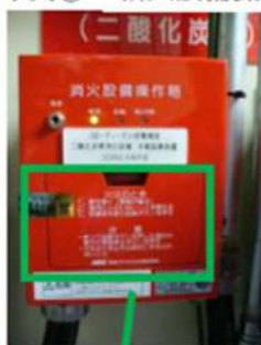
写真⑤ 消火設備操作箱
