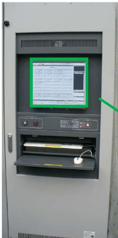
写真④ 中央制御室 総合操作盤
