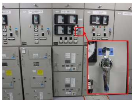
電源盤の施錠
