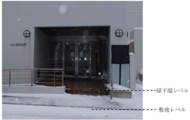
図3 建屋外壁扉（代表例）
