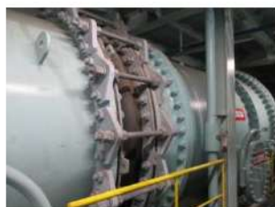
循環水管伸縮継手
