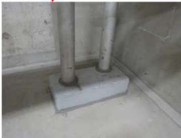
電線管貫通部
