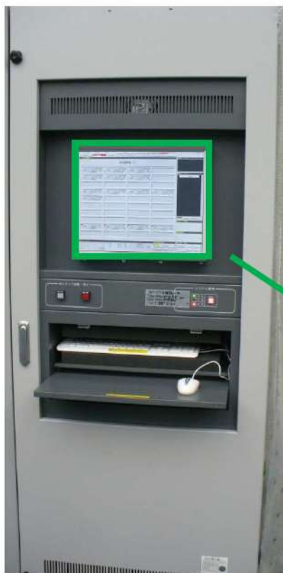
写真④ 中央制御室 総合操作盤
