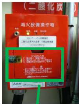
写真⑤ 消火設備操作箱
