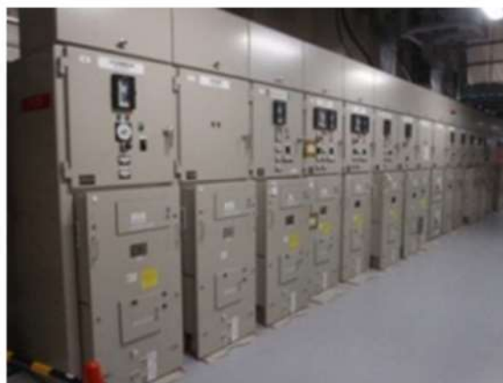
第 1-28 図：3A-安全補機開閉器室の状況
