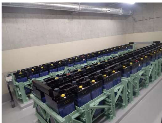
第 1-29 図：安全系蓄電池室の状況
