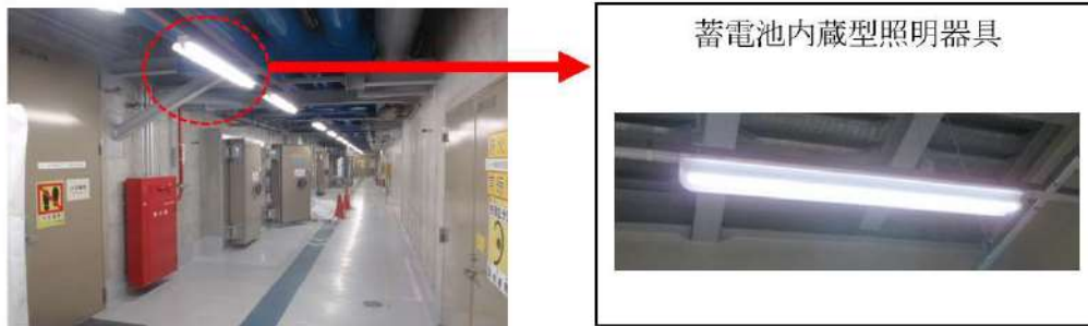
第 1-21 図：消火用非常用照明の概要
