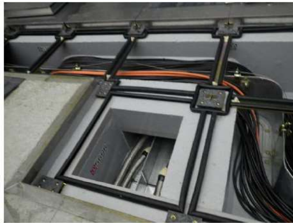
第 1-27 図：フロアケーブルダクトの状況
