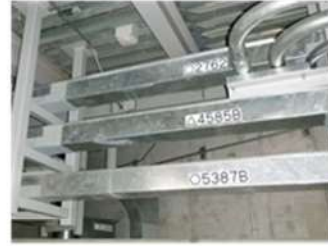
ケーブルトレイ，電線管の例
