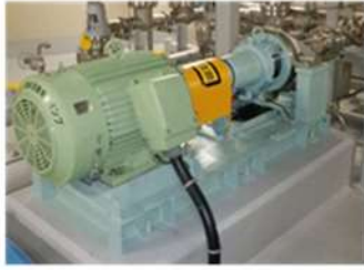
ポンプ，配管，支持構造物の例
