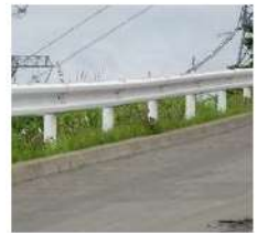
ガードレール
