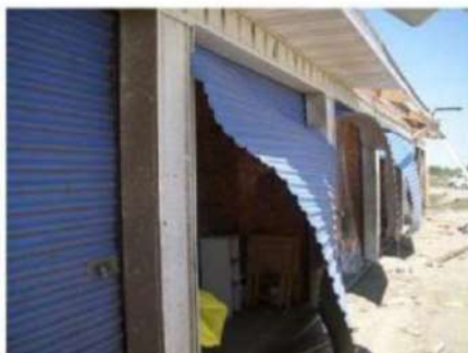
シャッターの被害
