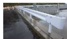
ガードレール
