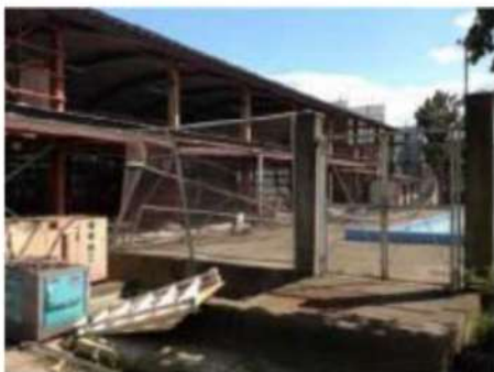
フェンスの被害（工事中の建築物）
