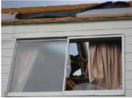
窓ガラスの損壊
