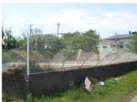
フェンスの被害状況
