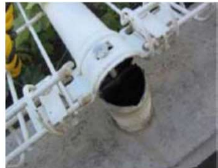
支柱部の破断
