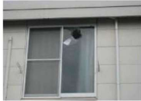
窓ガラスの飛来物衝突痕
