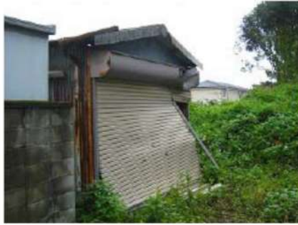
シャッターの外れ
