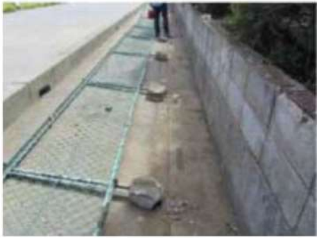
フェンスの倒壊
