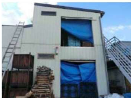
シャッターの被害
