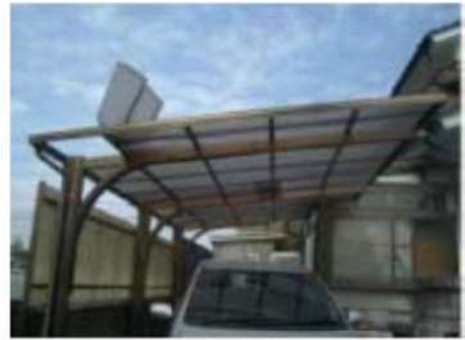
カーポート屋根の破損
