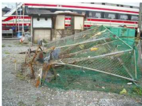
フェンスの著しい変形
