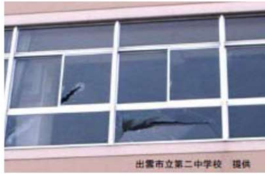
体育館窓ガラスの破損
