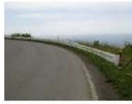
ガードレール
