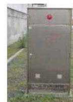
消火栓（ホース格納箱）
