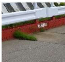
ガードレール
