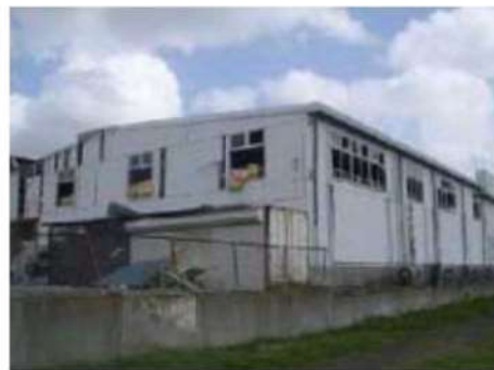
窓ガラスの破損
