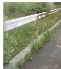
ガードレール
