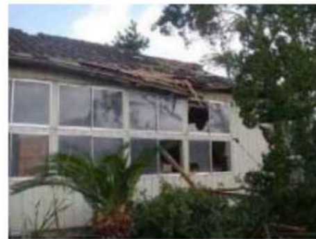
倉庫の窓ガラスと屋根の被害状況
