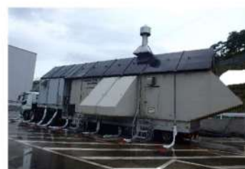
代替非常用発電機
