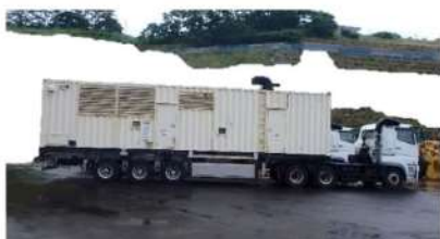
可搬型代替電源車
