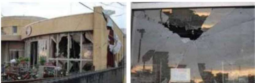
店舗の窓ガラスの被害状況
