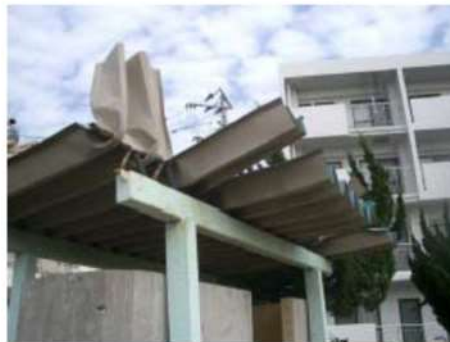
屋外トイレ屋根の損傷
