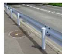
ガードレール
