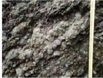
P5 防災科研調査において地滑り土塊南側端部とされる箇所付近の露岩状況 堅硬な岩盤（凝灰角礫岩）が認められる。
