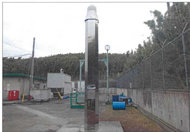
竹島の機器設置状況
