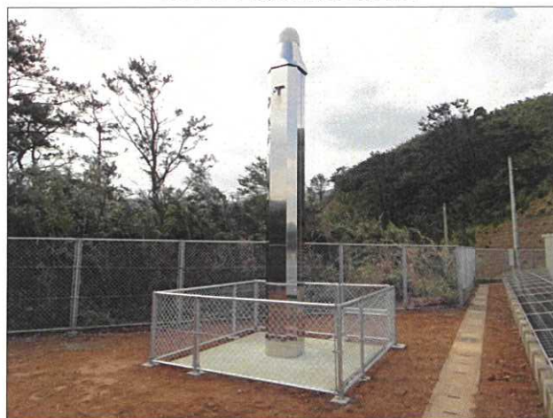
黒島の機器設置状況
