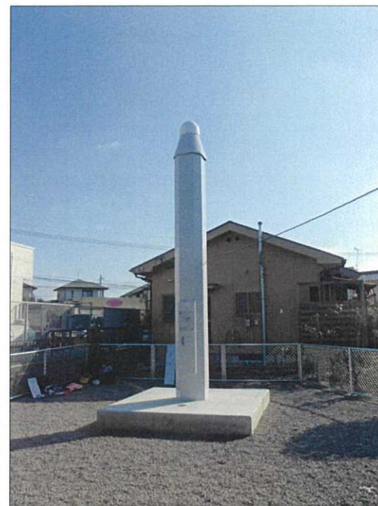
吉野町の機器設置状況
