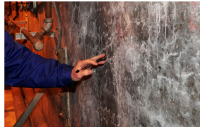
ASR（遅延膨張性）の発生状況例※ 4
