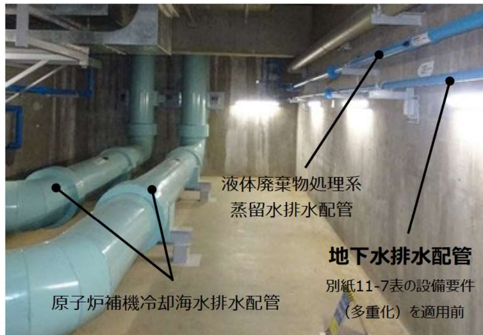
添付7-6図 地下水排水配管写真（電気建屋）
