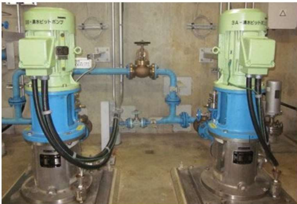
添付7-5図 湧水ピットポンプ写真
