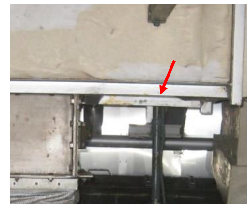
②ダクトサポートの汚れ (拡大)
