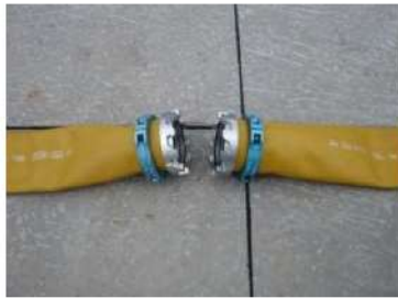
可搬型ホース（150A）接続前
