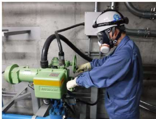
補助給水ライン流量調整 （周辺補機棟 T.P. 10. 3m（中間床））
