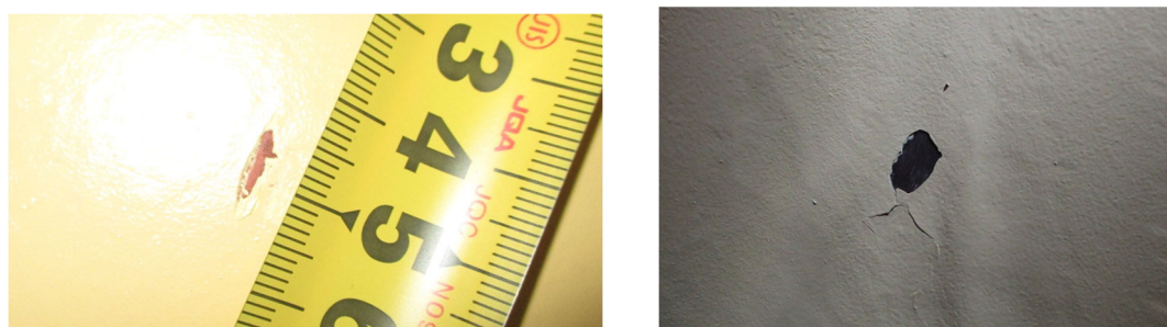
フロー②、③と判断した塗膜の劣化
