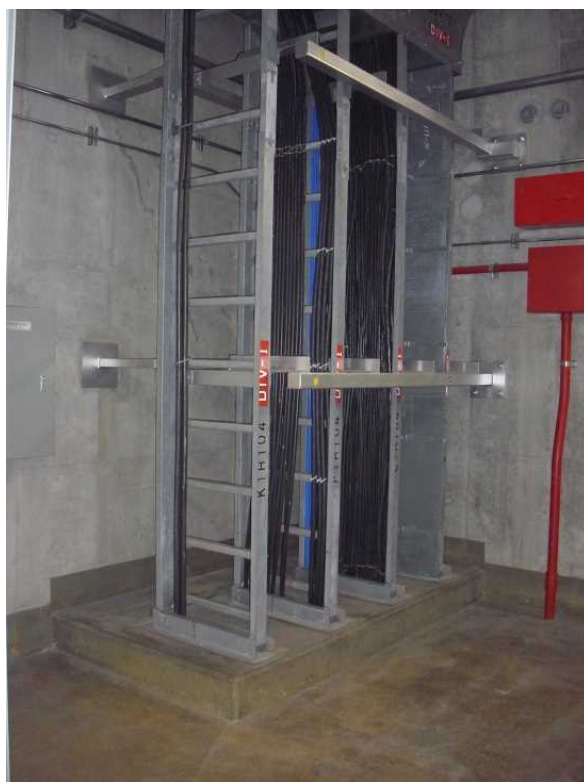
図2-1 ケーブルトレイ床貫通部外観
