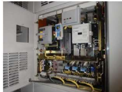
パワーコントロールセンタ
