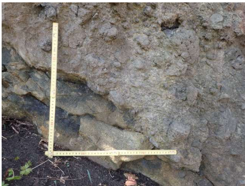
図 2.1.a.c-4 (14) 防潮堤（茶津側）露頭状況 P14 茶津川沿いの地山斜面中腹（P13 拡大） 凝灰角礫岩が分布し，C級からなる。
