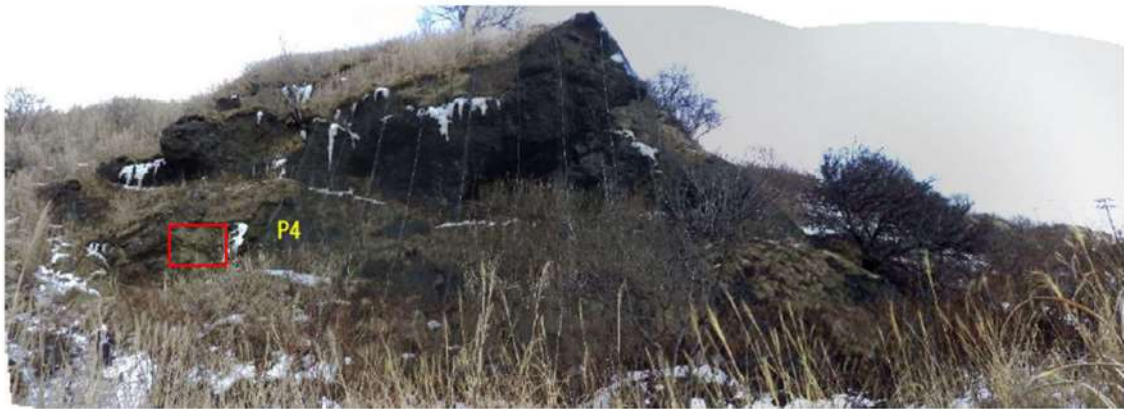
図 2.1.a.c-4 (3) 防潮堤（茶津側）露頭状況 P3 地山（海側） 凝灰角礫岩が分布する。
