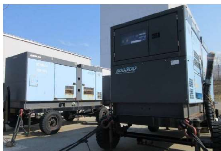
図4-11 緊急時対策所用発電機 外観
