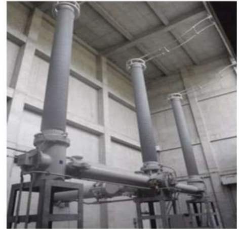
275kV ブッシング
