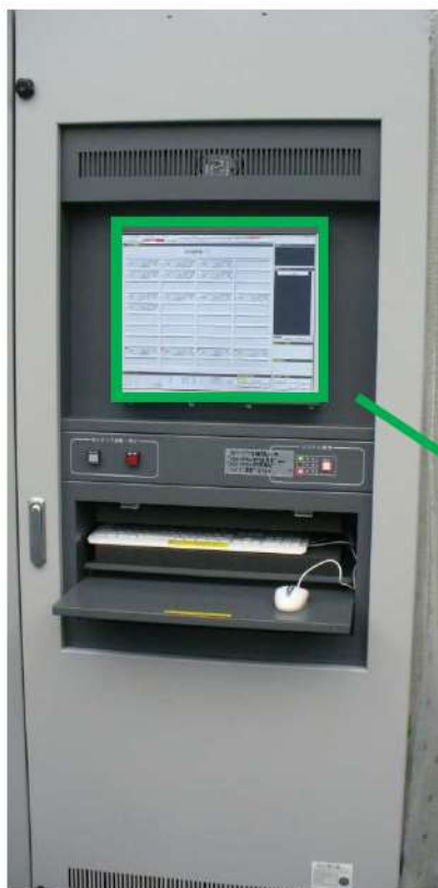
写真④ 中央制御室 総合操作盤
