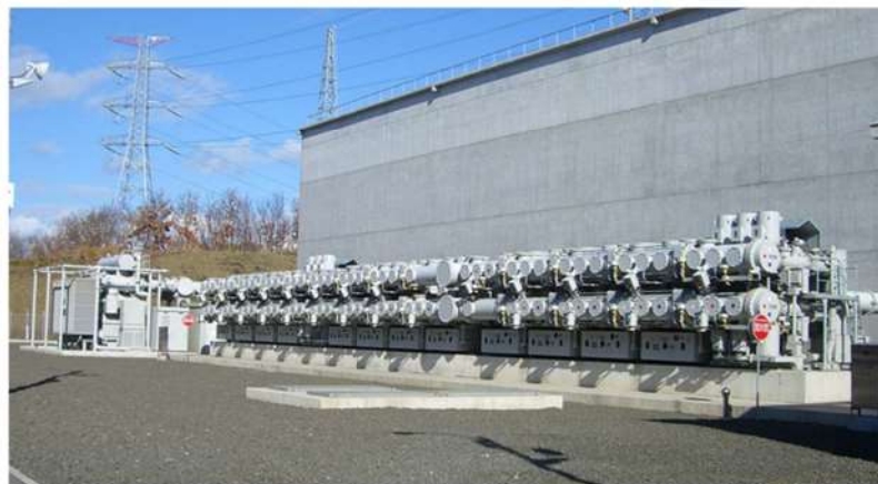
第 2.2.4.6 図 開閉所設備外観
