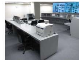
通常点灯時 (運転員安灯及び制御室運転員安灯)
