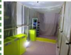
可搬型照明①
