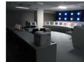
非常用照明点灯時
