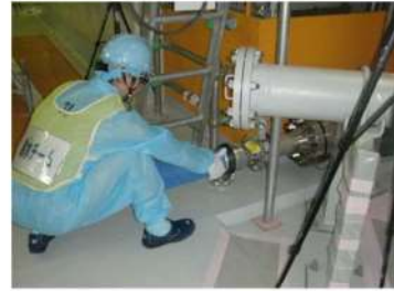
可搬型ホース敷設 (周辺補機棟 T. P. 33. 1m)
