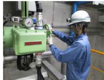
タービン動補助給水ポンプ 駆動蒸気入口弁「開」操作 （周辺補機棟 T. P. 10. 3m（中間床））
