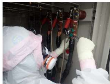
号炉間連絡ケーブル接続（端子） （屋外）
