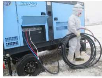
可搬型直流電源用発電機ケーブル敷設 (屋外)
