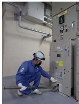
受電遮断器操作 (安全補機開閉器室) (原子炉補助建屋T.P. 10. 3m)
