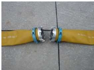
可搬型ホース（150A）接続前
