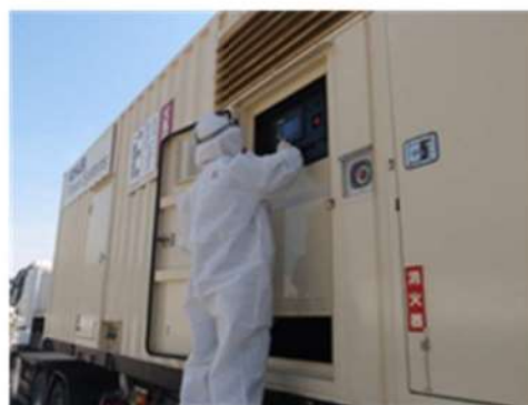
可搬型代替電源車起動 (屋外)
