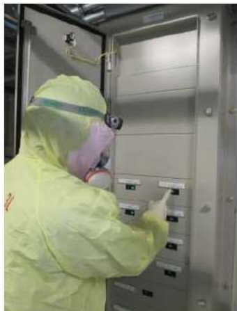
代替所内電気設備対象負荷の 切替・給電操作 (安全補機開閉器室) (原子炉補助建屋T.P. 10. 3m)
