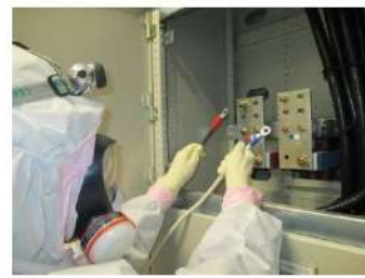
可搬型直流変換器 直流出力ケーブル接続(端子) (安全補機開閉器室) (原子炉補助建屋T. P. 10. 3m)
