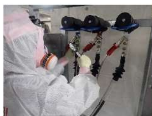
号炉間連絡予備ケーブル接続（端子） （屋外） （作業風景は類似作業）
