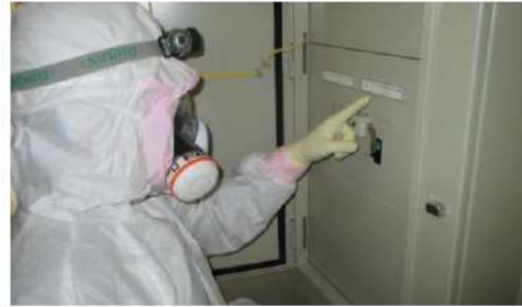
代替所内電気設備対象負荷の 切替・給電操作 (原子炉補助建屋T.P. 17. 8m)
