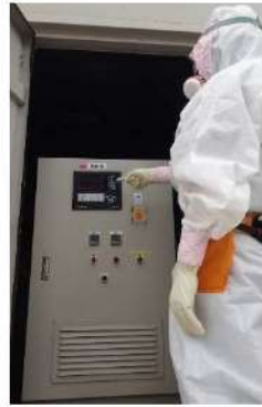
代替非常用発電機起動 (屋外)
