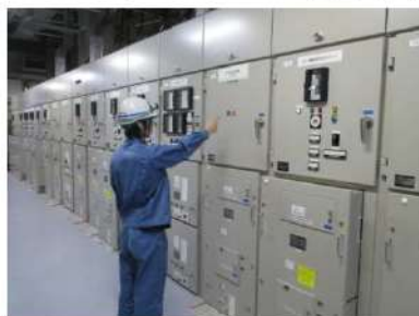
メタクラ電源確認 (安全補機開閉器室) (原子炉補助建屋T.P. 10. 3m)
