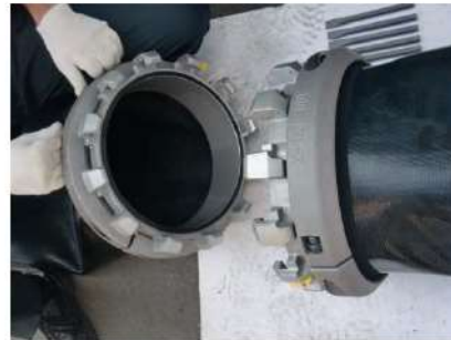
可搬型ホース(300A)接続
