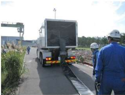
ホース延長・回収車（放水砲用） による可搬型ホース敷設 (屋外)
