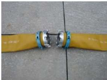
可搬型ホース（150A）接続前
