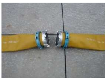
可搬型ホース(150A)接続前
