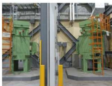
(原子炉補機冷却海水ポンプ電動機予備品)
