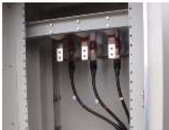
図 57.12.4 号炉間連絡予備ケーブル接続箇所
