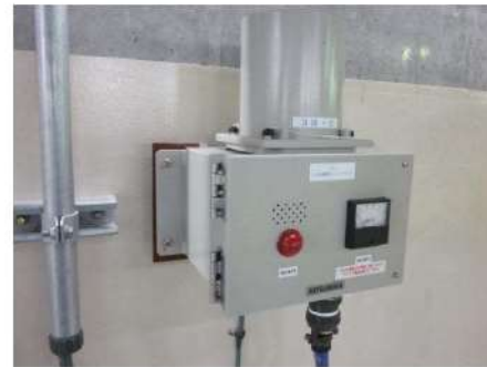
機器の固定状況
