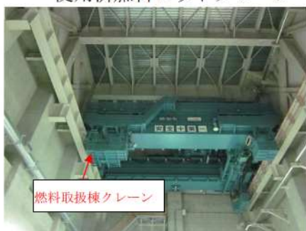
燃料取扱棟クレーン
