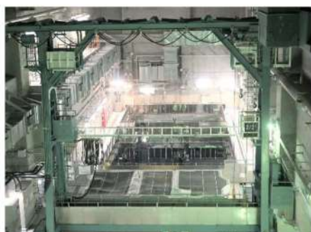
使用済燃料ピットクレーン
