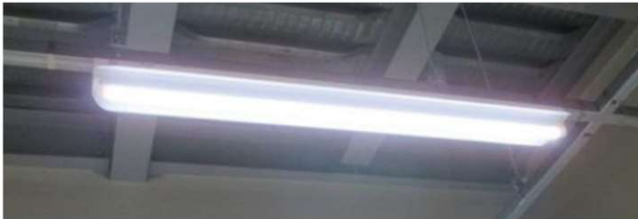
無停電運転保安灯
