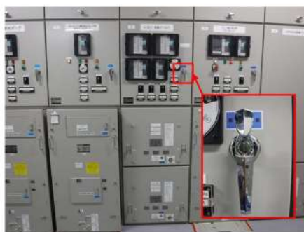
電源盤の施錠
