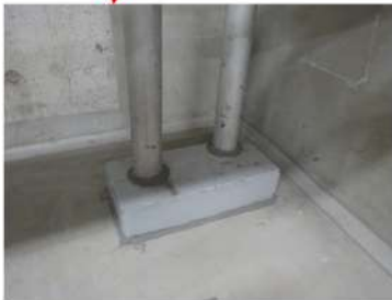
電線管貫通部
