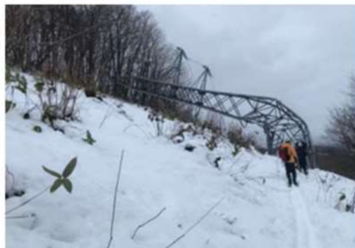
大雪による鉄塔倒壊事例 ※3
