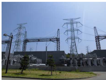
(a) 500kV 超高压開閉所
