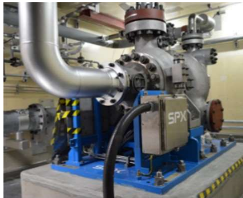
高圧代替注水ポンプ
