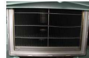
装置底部 (PAR 入口給気口)
