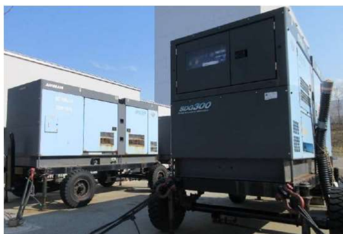
図4-11 緊急時対策所用発電機 外観
