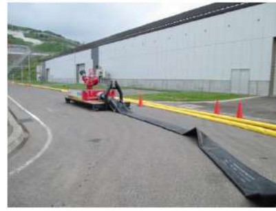
放水砲設置 (屋外)
