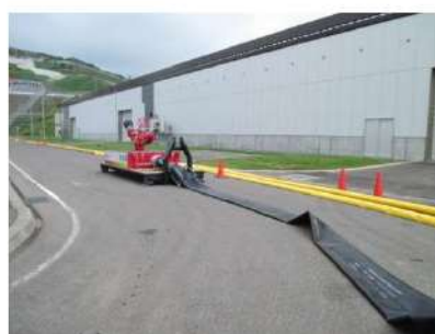
放水砲設置 (屋外)
