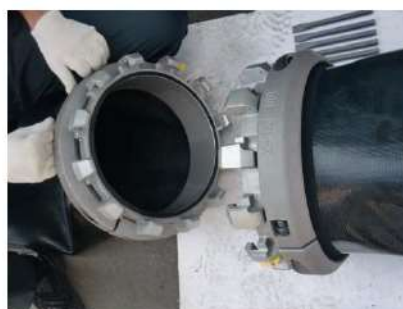
可搬型ホース(300A)接続
