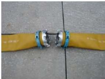
可搬型ホース（150A）接続前
