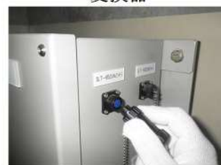
ケーブル接続 BOX
