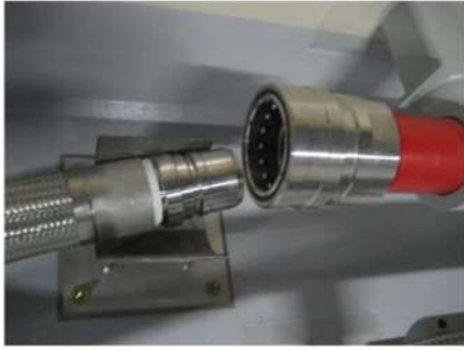
消火水系配管と 格納容器スプレイ系配管との 接続のための可搬型ホース接続前 (運転員(現場) B) (原子炉補助建屋 T. P. 10. 3m)
